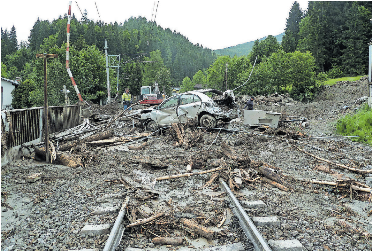
Murenabgänge häufen sich und gefährden auch die Bahninfrastruktur. Als Schutzmaßnahmen kommen zusätzliche Galeriebauten in Frage. Bei Vorbeugung und Reaktion helfen zudem intelligente Systeme des Naturgefahrenmanagements. [ÖBB]
